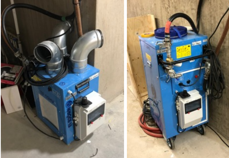
Bild: Värmemaskiner för hetvatten, 15 och 30 kW. Varje värmemaskin är uppkopplad med möjlighet att styra på distans.
